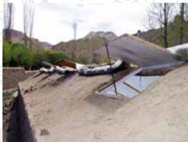
تصویر 11:- نمای خارجی هواکش نصب شده و باز در سقف
