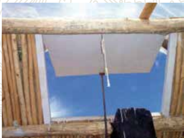
تصویر 10:- نمای داخلی هواکش نصب شده و باز در سقف
